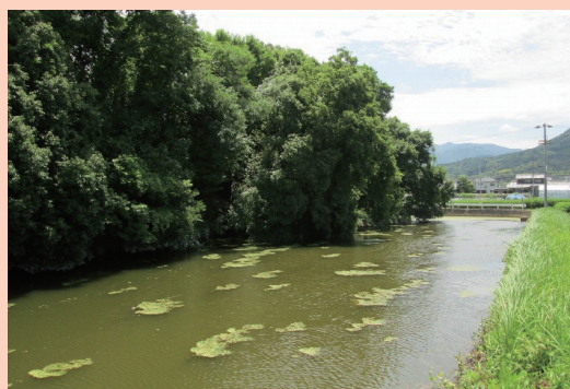
西側土塁被災状況(平成30年7月12日)
